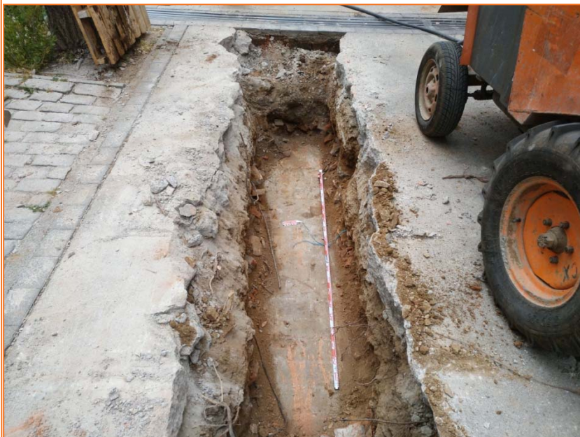
Foto 14. Vista des de l'est del paviment UE 46 d'un àmbit del número 1-3 del carrer dels Segadors.
